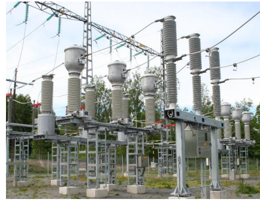
Figure 12: 145 kV SF 6 free switchgear in Fårhult (Schweden)
